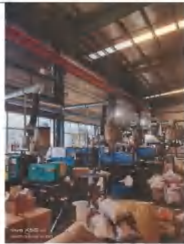
有机废气收集装置
